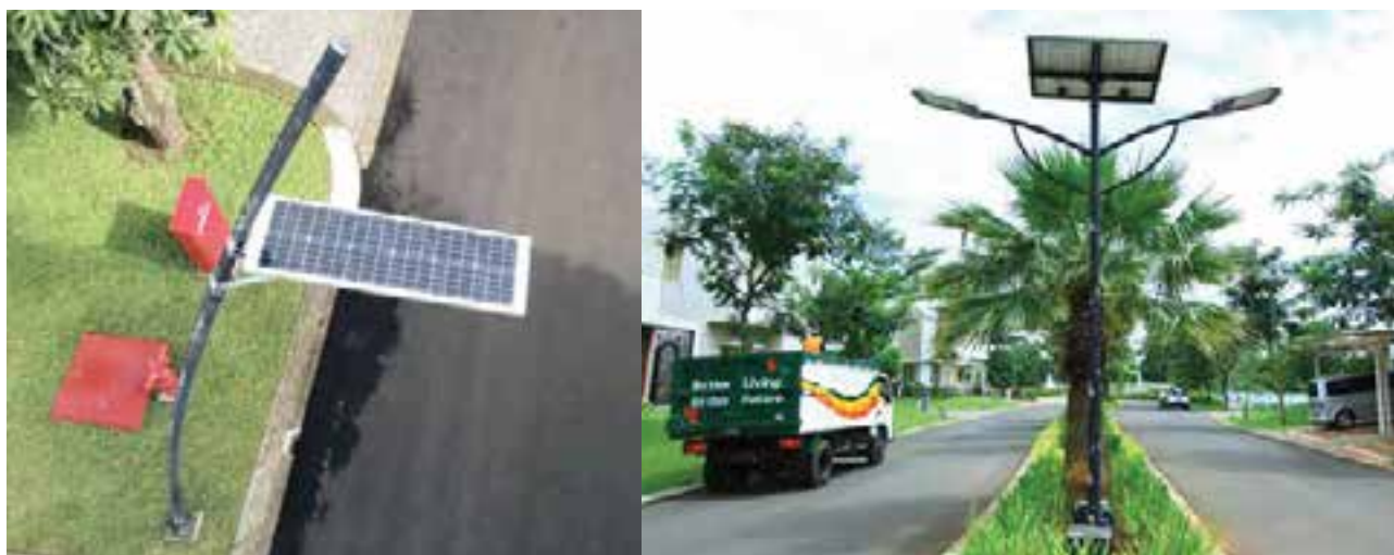
Penerangan Jalan Umum Panel Surya, Summarecon Serpong
